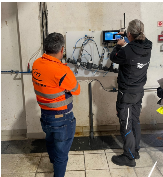
Captação de água numa ETA
