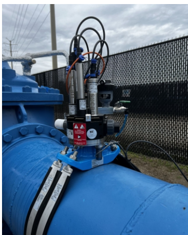
Rede de distribuição
